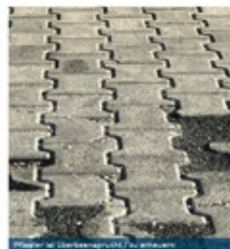
Plaster ist überbeansprucht, zu erneuern
